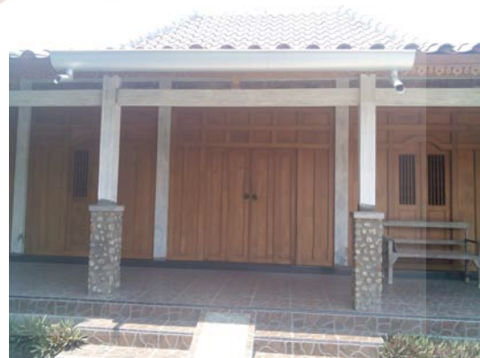
Gambar 12: Gebyog sebagai dinding bagian emper omah Jawa di pedesaan, dimana saka diganti dengan kolom beton (Foto: Budiwiyanto, 2016)
