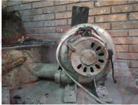
Gambar 61 : Blower fan Diambil : 10/5/2017 (Foto : Intan Anggun P., 2017)
